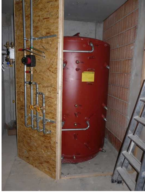
Der SWISS SOLARTANK der Fa. JENNI wurde mit der Installationswand eingehaust und mit Einblasdämmung isoliert.
