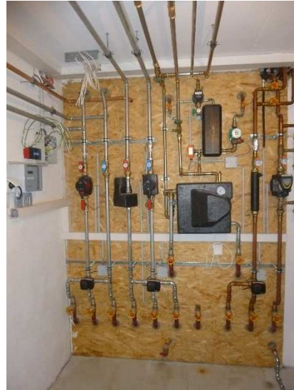
Ein Blick in den Technikraum (gleich nach der Rohmontage).
