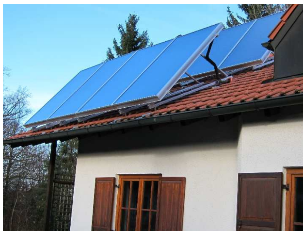
Die 22 m 2 große Kollektoranlage wurde in zwei Reihen im optimalen Neigungswinkel aufgeständert.
