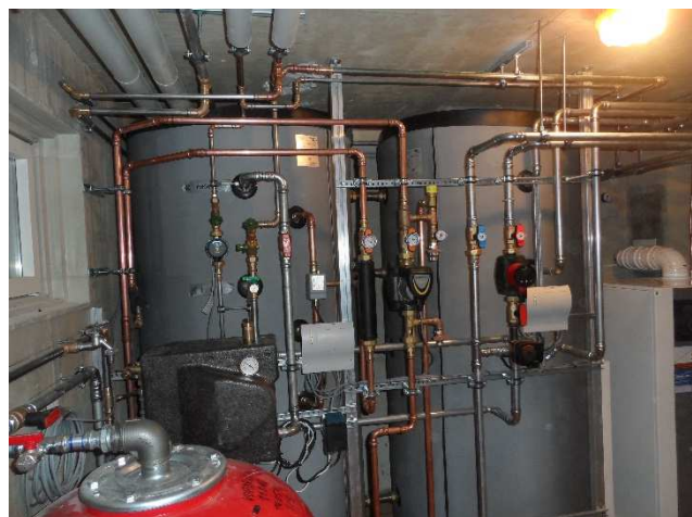
Die Technik: 2 x 1.000 l Pufferspeicher als Satellitsystem mit zweistufiger Solarbeladung und hygienischer Trinkwassererwärmung mit Frischwassermodul Typ TRT.
