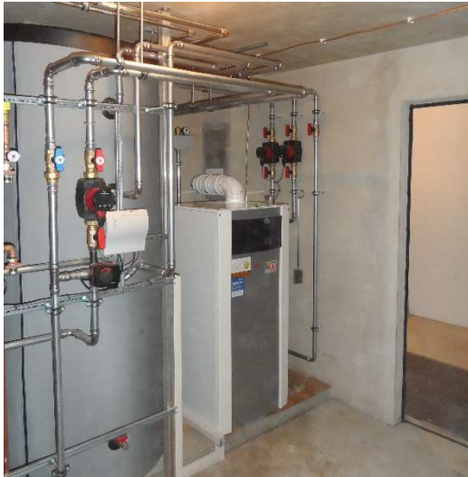
Die Nachheizung erfolgt durch einen Öl-Brennwertkessel von WOLF. Die Kesselregelung übernimmt auch den kompletten Solarkreis.
