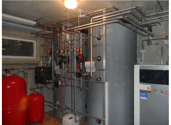
Die Handschrift des Installateurs: Sauber gebaut, vorbildlich verrohrt. Trotz des komplexen Aufbaus ist die Installation übersichtlich und aufgeräumt.
