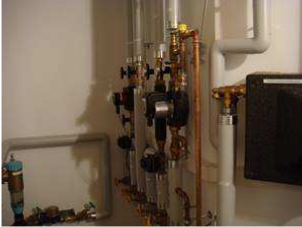
Die Technik ist kompakt im Hausanschlussraum untergebracht. Der Pufferspeicher ist hinter der Trockenbauwand eingebaut.
