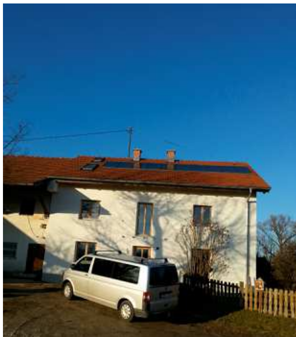
Ohne Sonne geht's nicht: Die thermische Solaranlage ist wichtiger Bestandteil des Sanierungskonzepts.
