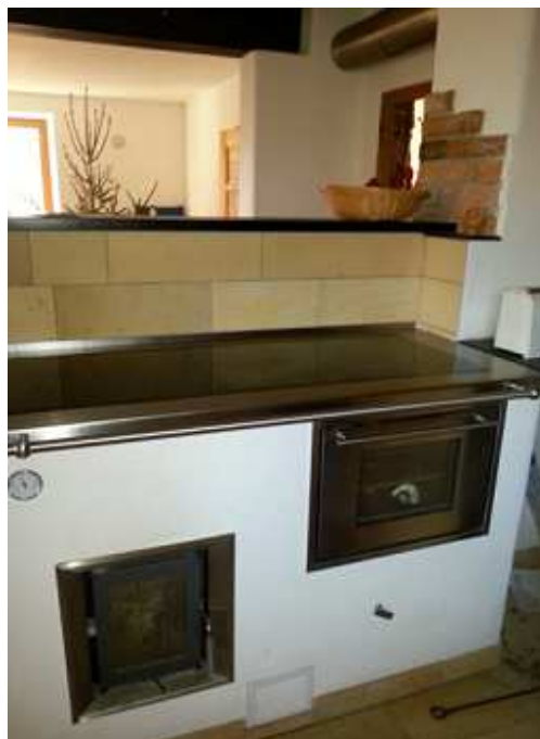
Kochen und Heizen mit Holz: Der Heizherd mit 15 kW Nennwärmeleistung speißt in den Pufferspeicher ein.
