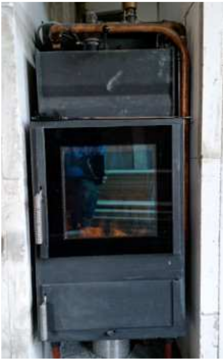
Einzigste Nachheizquelle ist der POWALL OFKA Holz-Zentraleisungssofen. Der Heizeinsatz wird komplett ummauert.
