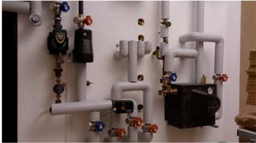
Ein Blick in den noch nicht ganz fertigen Technikraum im Dachgeschoss.
