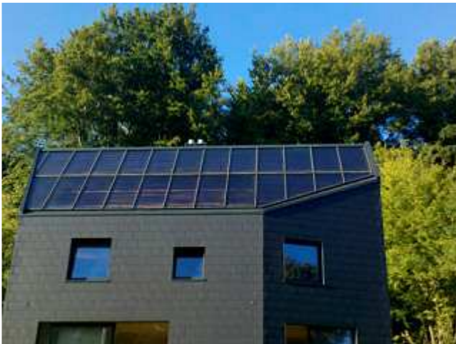
Maßgeschneidert: Der Hochleistungsflächenkollektor wurde in das asymmetrische Dach eingepasst.
