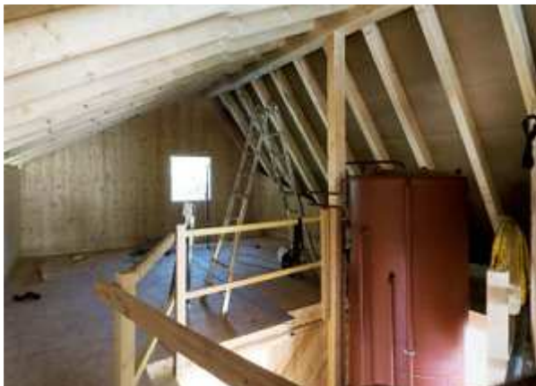
Der 7,20 m hohe und schlanke Speicher reicht bis in das Dachgeschoss. Durch die schlanke Bauform wird eine optimale Temperaturschichtung begünstigt.
