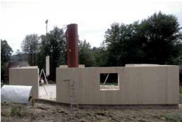
Der 8.000 l große Solartank wurde komplett mit angeschweißter Verrohrung vor Aufstellen des Gebäudes auf die Bodenplatte gesetzt.
