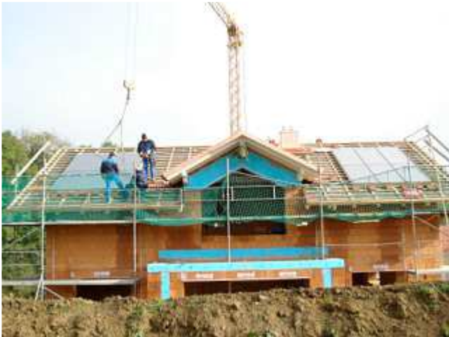
DBilder von der Kollektormontage: Jedes der beiden 3 x 4 m großen Kollektormodule wurde in einem Stück mit dem Kran auf das Dach gehoben.
