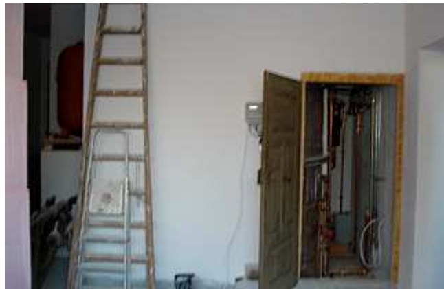
Hinter der Einhausung befindet sich der 8.000 l Solartank
