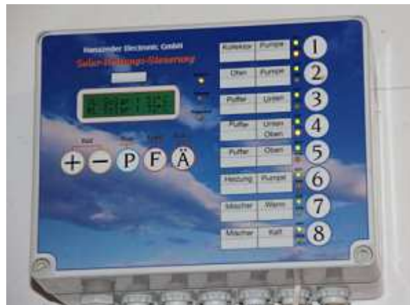
Die freiprogrammierbare Steuerung regelt die komplette Solarbeladung, den Heizkreis und den Ofen-Ladekreis.
