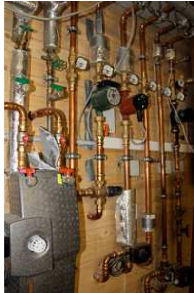
Der Technikraum nach der Rohinstallation. Die Installation ist komplett in einer Kellervertiefung untergebracht.
