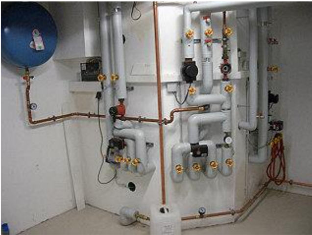
Ein Blick in den Technikraum: Hinter der Trockenbauwand verbirgt sich der ca. 9.000 l große SWISS SOLARTANK.
