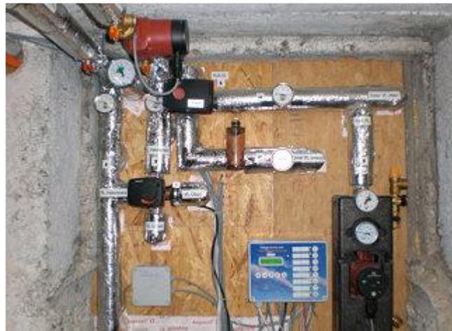
Die Platzverhältnisse im Technikraum sind etwas beengt. Hinter der OSB-Wand befindet sich der 7.300 l fassende SWISS-SOLARTANK.
