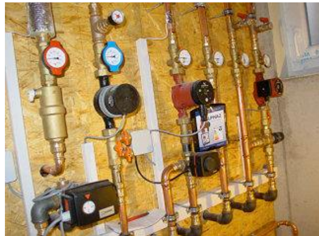
Hinter der Installationswand befindet sich der knapp 7.000 l große und 3,60 m hohe Pufferspeicher, der in einer Kellervertiefung von ca. 1,50 m steht.
