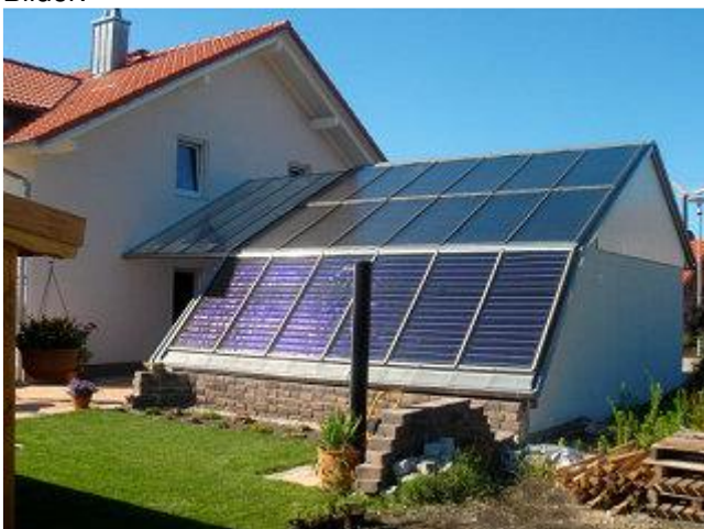
Kollektoranlagen müssen sich nicht immer auf dem Dach befinden – bei Fam. Hautz wurden das Garagendach sowie die Fortsetzung des Daches als Schrägfassade genutzt.
