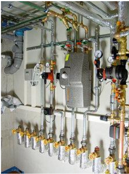
Ein Blick in den Technikraum; der 12.300 l fassende SWISS-SOLARTANK befindet sich hinter der Installationswand.
