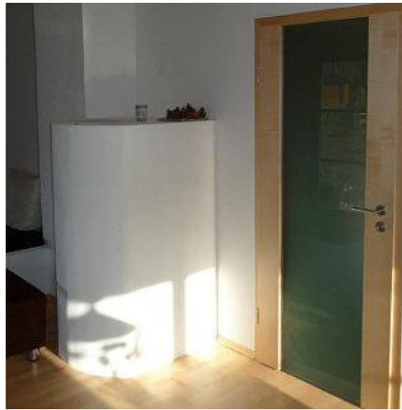
Die Ofenummuerung im Wohnzimmer ist mit zusätzlich mit 10 mm starken Wandheizrohren versehen. So kann die Ofenbank mit der Energie aus dem Pufferspeicher temperiert werden.
