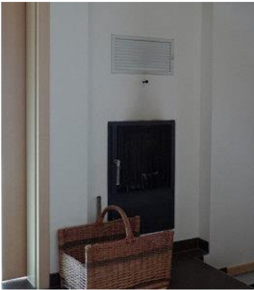
Der Powall OFKA Holz-Zentralheizungsofen wird nur in der Kernzeit des Winters benötigt. Die Beschickung erfolgt von der Gangseite aus.
