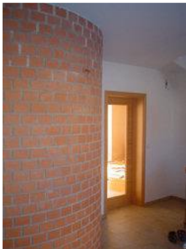
Der zentral im Gebäude stehende Speicher wurde mit eine Vollziegel-Ummauerung ansprechend eingehaust.
