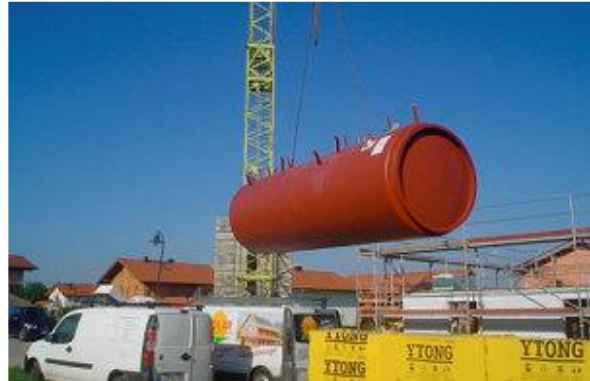
Der Speicher wurde ‚just in time‘ geliefert und vor Aufbringen der Obergeschossdecke mit dem Baukran eingehoben.
