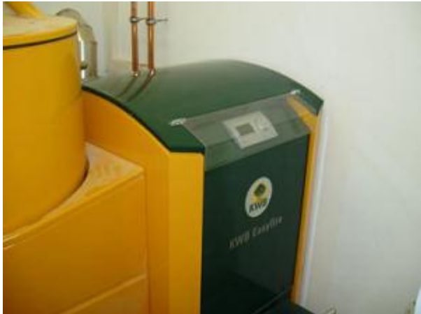
Der Pelletkessel heizt nach, wenn's mal nicht reicht.
