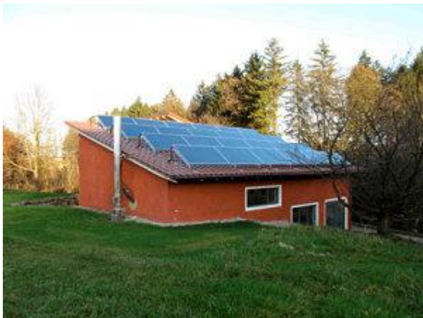
Die 62 m 2 -Aufdach-Kollektoranlage findet auf dem Süddach des Werkstattgebäudes Platz. Der Edelstahl-Außenkamin ist für das Schmiedefeuer.
