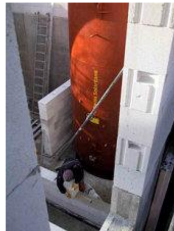
Der 20.000 l Solartank mit 2,30 m Durchmesser und 5,25 m Höhe wurde im Werkstattgebäude mit einer Ummauerung eingehaust.
