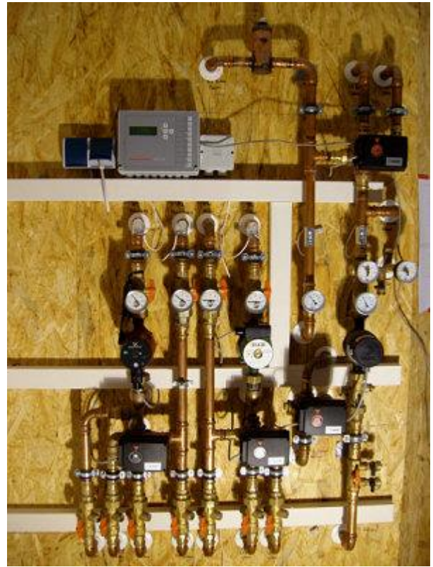
Technikzentrale: Der Ofenkreis ist mit einem 4-Wege-Bivalentmischer zur motorischen Rücklaufanhebung und Pufferbeladung auf zwei Niveaus ausgestattet.
