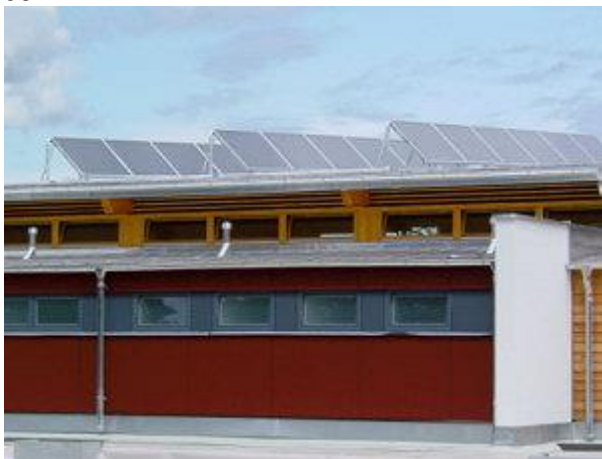
Die Kollektoranlage des ersten Abschnitts besteht aus 18 Querformat-Aufdachmodulen mit je 2,57 m 2 Fläche.
