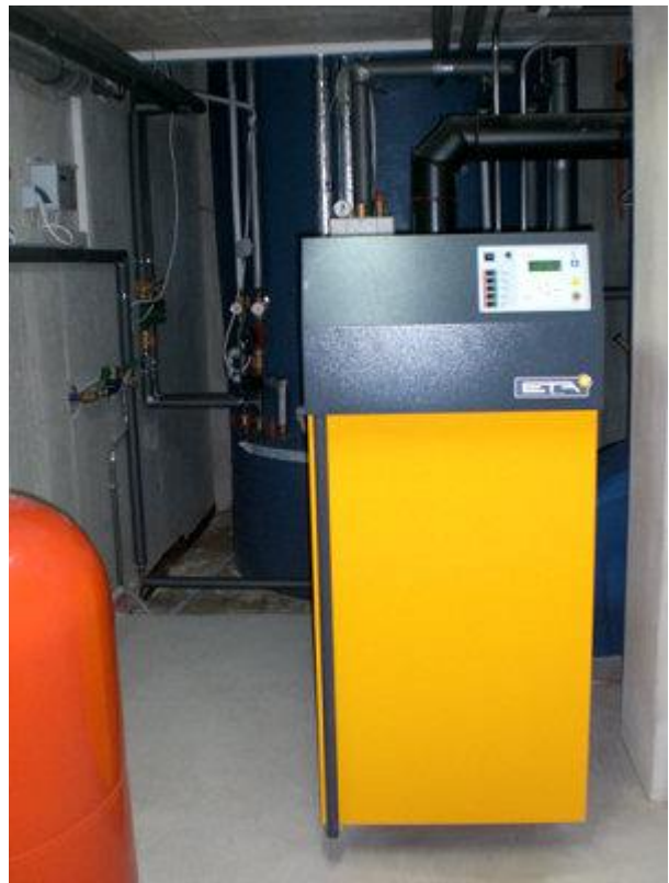
Der Restwärmebedarf wird mit einem großen, komfortabel zu bedienenden Holzvergaserheizkessel für Halbmeterscheite abgedeckt.
