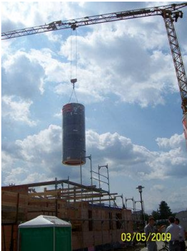
Ein Bild von der Speicher-Einbringung. Der über zwei Geschosse reichende Puffer wurde komplett vorverrohrt und mit werkseitiger Wärmedämmung geliefert.
