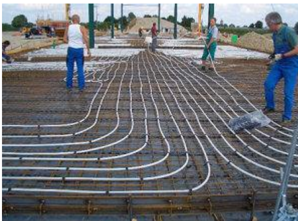
Im Bereich der Produktionshallen sind die Heizrohre auf der
