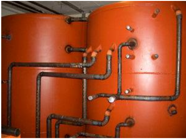
Die fertig geschweißten Pufferspeicher mit Verrohrung.
