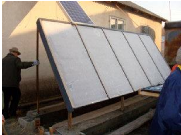
Der Kollektor ist auf 55° frei aufgeständert. Das PV-Modul oben liefert den Strom für Pumpen und Steuerung.
