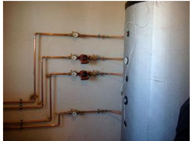
Der 1.000 l Kombipuffer enthält einen Trinkwasser-Wärmetauscher für optimale Hygiene.
