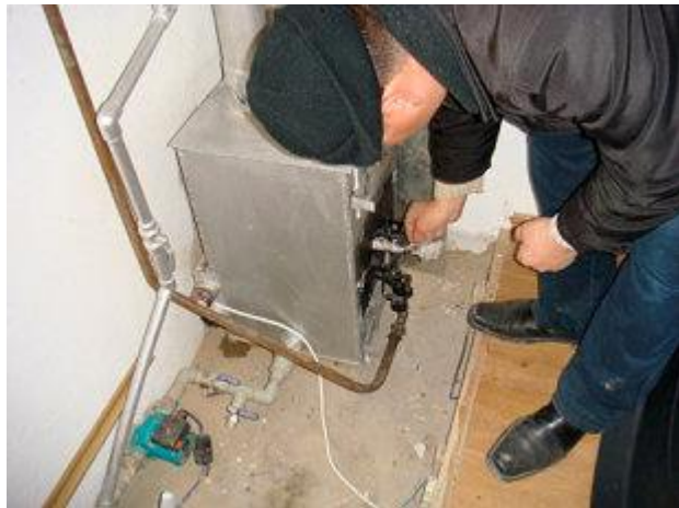
Technik aus der Sowjet-Zeit: Die einfachen Naturzugkessel werden mit Holz, Kohle, Gas oder Strom betrieben.
