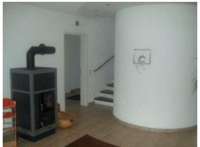
Einzigste Nachheizquelle ist der POWALL-Zentralheizungs-Kaminofen. Im Treppenauge steht der verkleidete Pufferspeicher.
