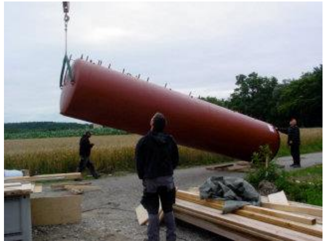
Der 15.000 l Kombispeicher ist ca. 7,50 m hoch.
