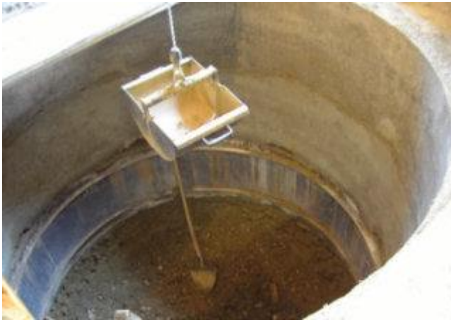
Für den Pufferspeicher wurde eigens ein Kellerraum vertieft.
