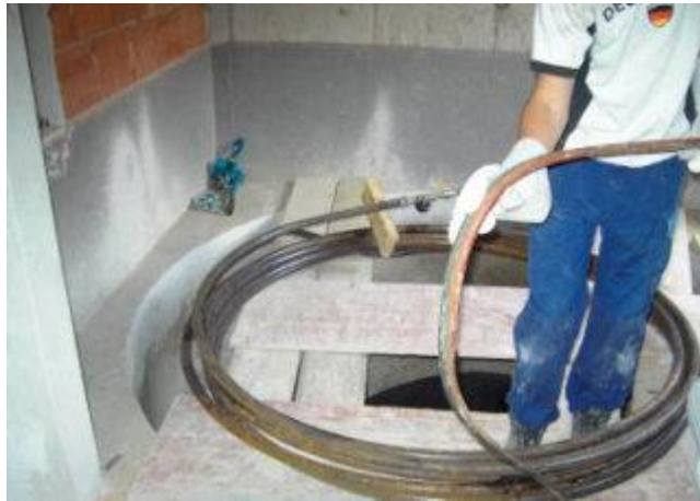
Auch die integrierten Solar-Wärmetauscher aus nahtlosem Stahlrohr DN 25 hat der Bauherr selbst hergestellt.
