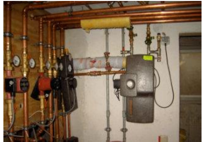
Das Warmwasser wird mit einem Frischwassermodul im Durchlaufprinzip bereitgestellt.
