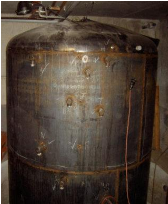
Der Pufferspeicher ist zur Hälfte im Boden versenkt.
