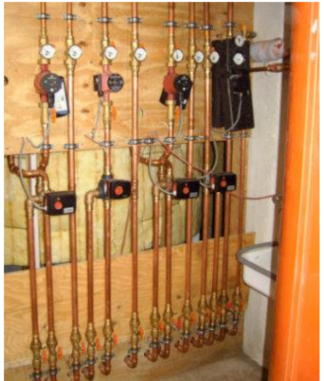
Ein Blick auf die Technikauminstallation im Rohzustand. Die Heizkreise ziehen aus 2 bzw. 3 Pufferniveaus.
