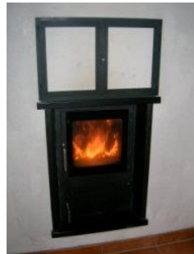
Der POWALL Zentralheizungsofen wird von der Küche aus befeuert.
