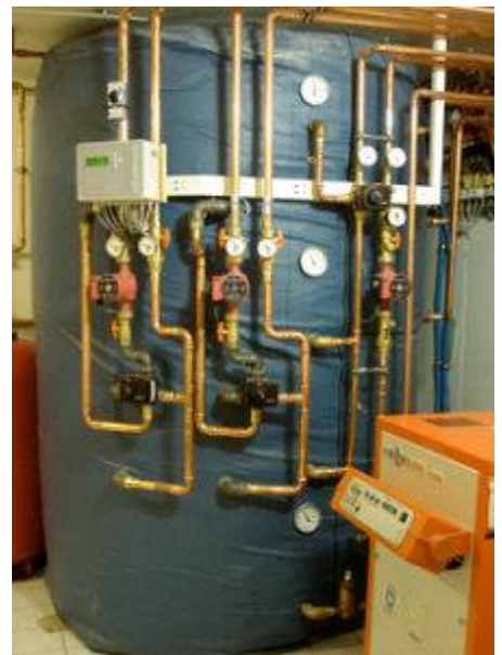
Die Energiezentrale: Pufferspeicher 2.600 l mit externem Frischwassermodul und exergiegerechter Entladung (2 Heizkreise).
