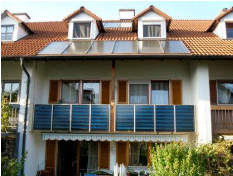
Die Kollektorfelder an der Balkonbrüstung und auf dem Dach werden in Reihe durchströmt. Im Winter bewirkt diese Verschaltung bei Schnee ein Abtauen der Dachkollektoren.
