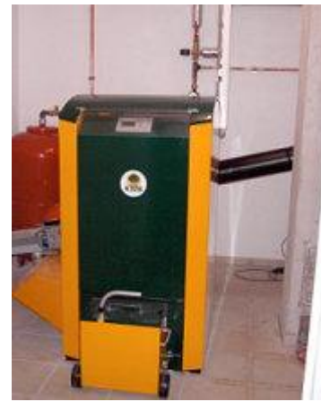
Zur Nachheizung ist ein 30 kW Pellet-Heizkessel installiert
