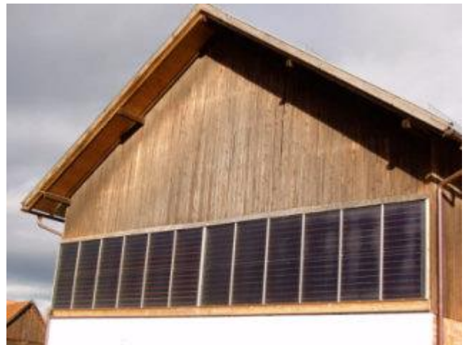
Der Fassadenkollektor wurde in die Südwand des Stadels integriert.
