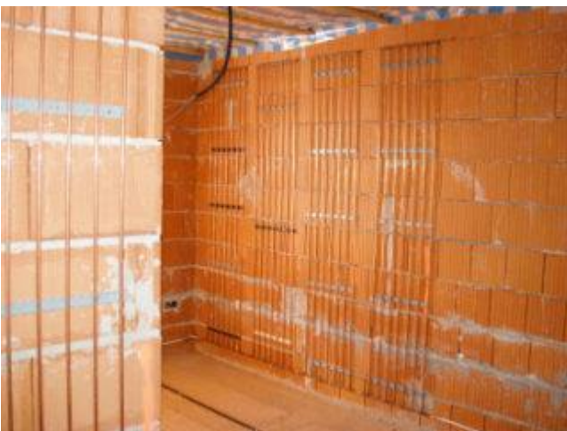
Die Unterputz-Wandheizungsregister im Neubau vor dem Verputzen.
