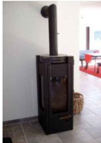
Für gemütliche Stunden: Der Kaminofen dient als zusätzliche Heizquelle (ohne Heizungsanschluss).
