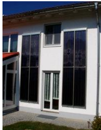
Der Fassadenkollektor unterstreicht die moderne Linie des Gebäudes
