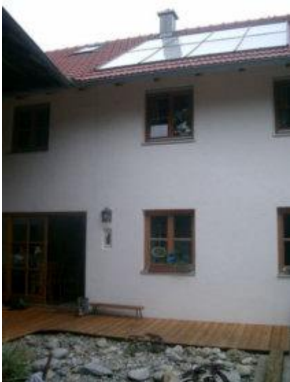
Der 4 x 4 m große Hochleistungsflächenkollektor auf dem Süddach des neuen Anbaus.
