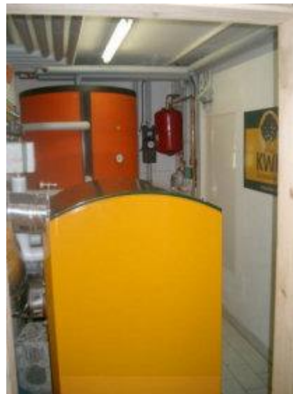
Ein Blick in den Technikraum: Pelletheizkessel und Solar-Kombispeicher 1.500 l
