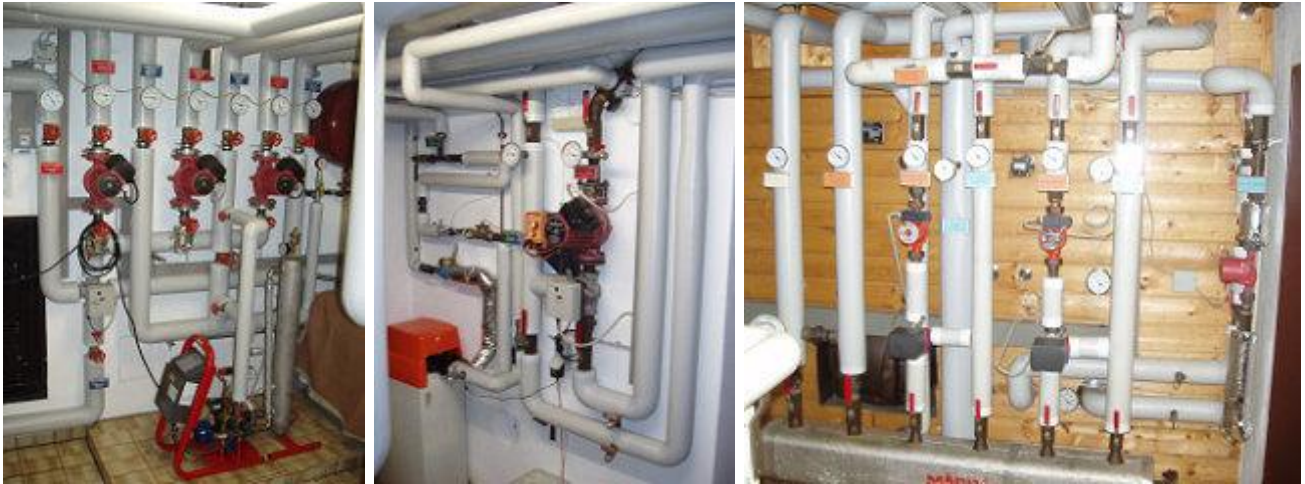
Große Kaliber: Pumpen und Installation vor dem Umbau
