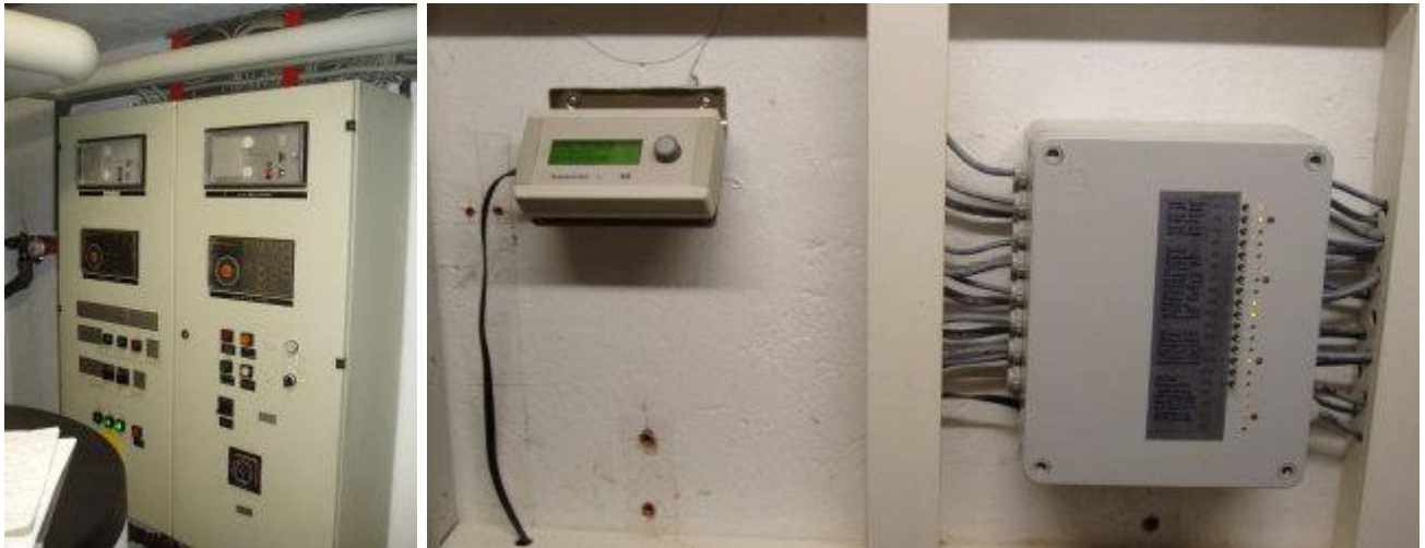
Vorher – nachher: Alte Schaltschränke – neue freiprogrammierbare Komplett-Regelung
