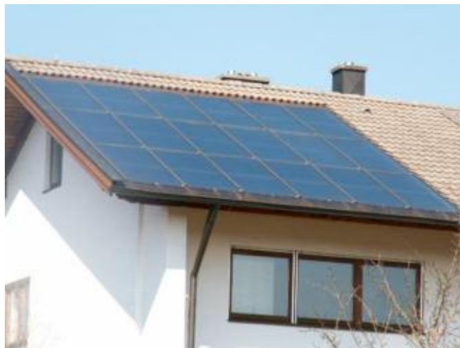
Der 36 m 2 Hochleistungsflächenkollektor reicht bis zur Traufkante.
