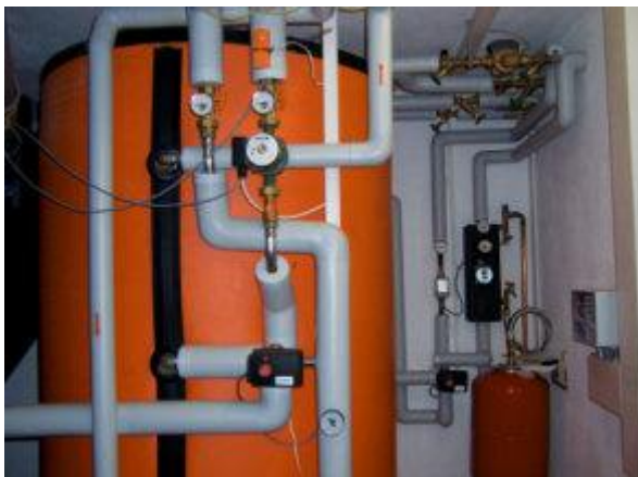
Ein Blick in den Technikraum: Der Kombispeicher mit zweistufiger Solarbeladung und Vorwärmung sowie heizkreisseitiger
