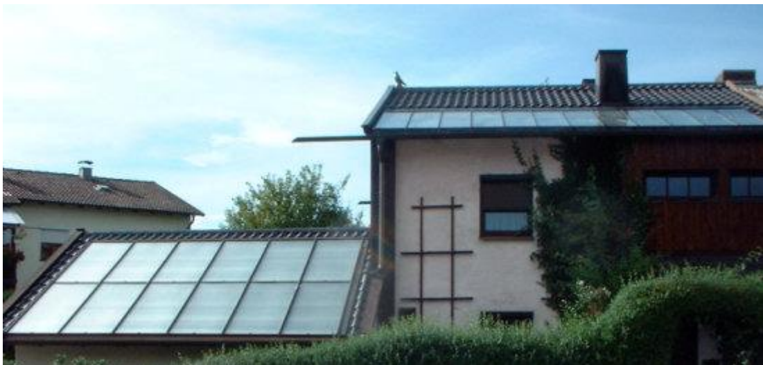
Rechts auf dem Hausdach die ursprüngliche ca. 13 m 2 Kollektoranlage, auf dem Garagendach der neue 24 m 2 Hochleistungsflächenkollektor. Im Keller unter der Garage steht der große Kombispeicher.
