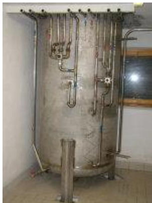
Echte Wertarbeit: Der Pufferspeicher mit zwei Wärmetauschern wurde komplett aus Edelstahl maßgefertigt
