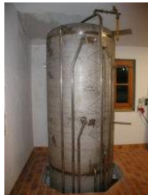
Der 5 m hohe Pufferspeicher reicht über zwei Etagen
