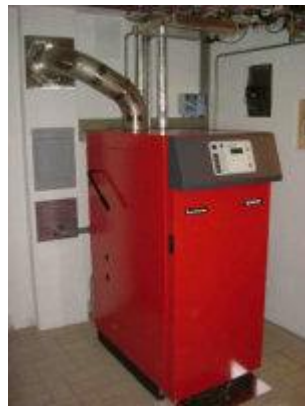
Liebe zum Detail: Abgasrohr und Rosette aus Edelstahl in Eigenfertigung
