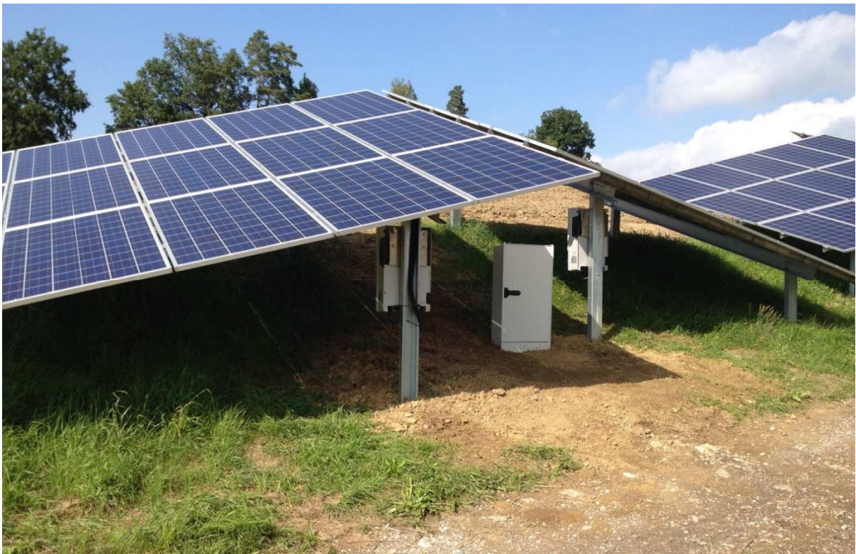
Die Wechselrichter und der Stromanschluss der Anlage im Schatten der Module. Von hier führt ein Erdkabel mit 150 Meter Länge zur Technik der Wasserversorgung.
