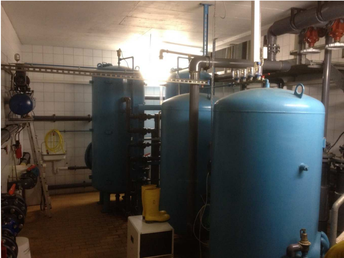
Der Technikraum der Wasserversorgung.
