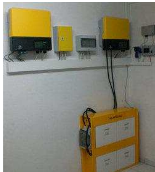
SMA Wechselrichter und Backup-System.
