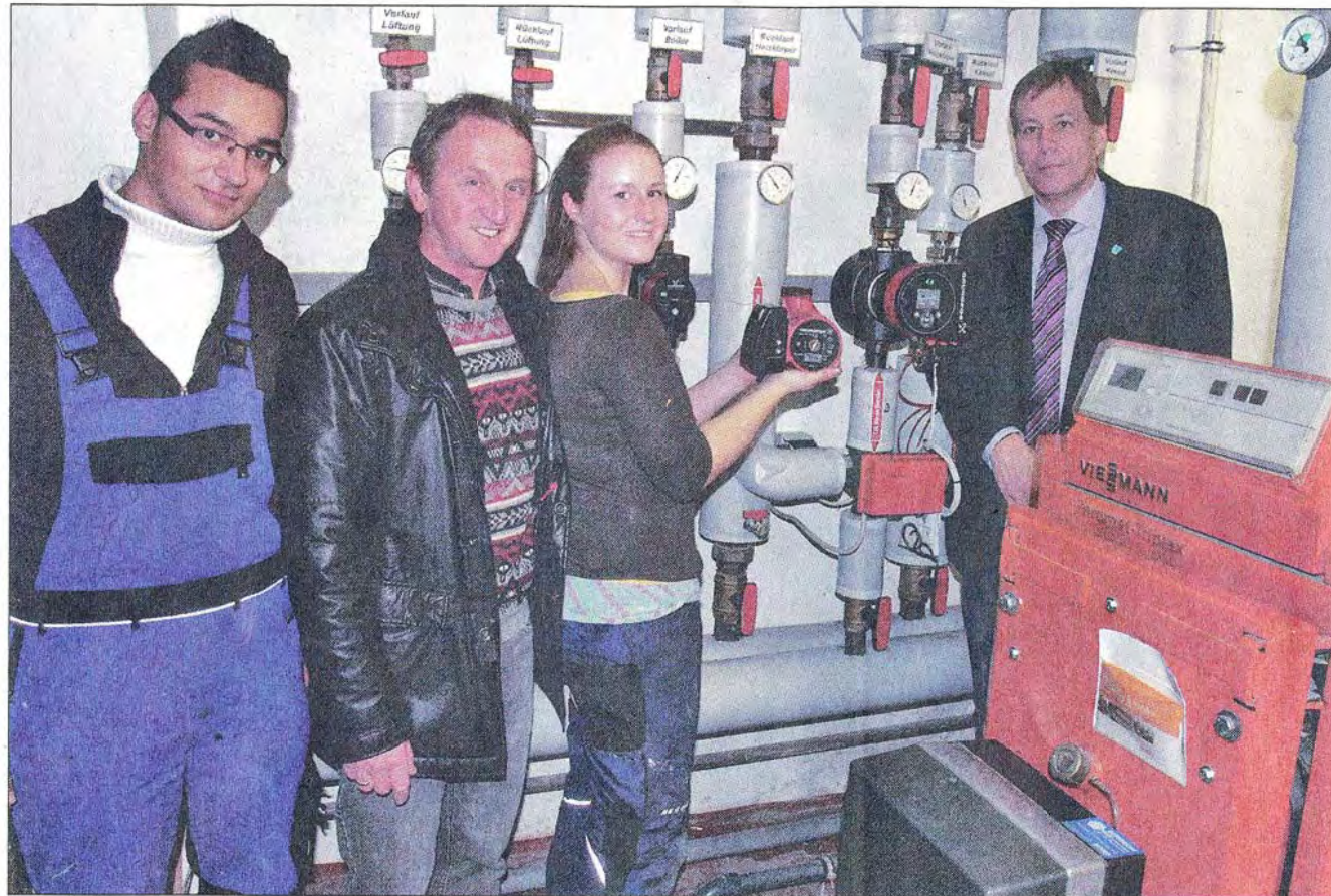
Sahin Anda, Hans Stalleicher, Elisabeth Weiße und Bürgermeister Karl Schleid (von links) präsentieren die neue Heizungspumpe des Rathauses. Foto: fam
