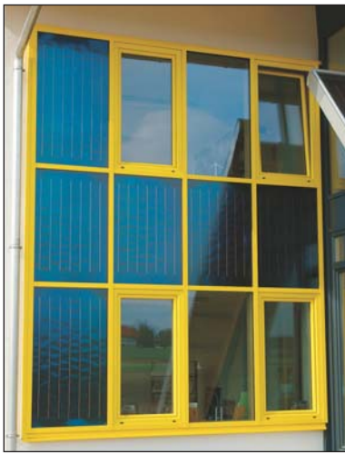
In der südseitigen Außenwand sind weitere 16 Quadratmeter senkrechte Fassadenkollektoren eingebaut.
