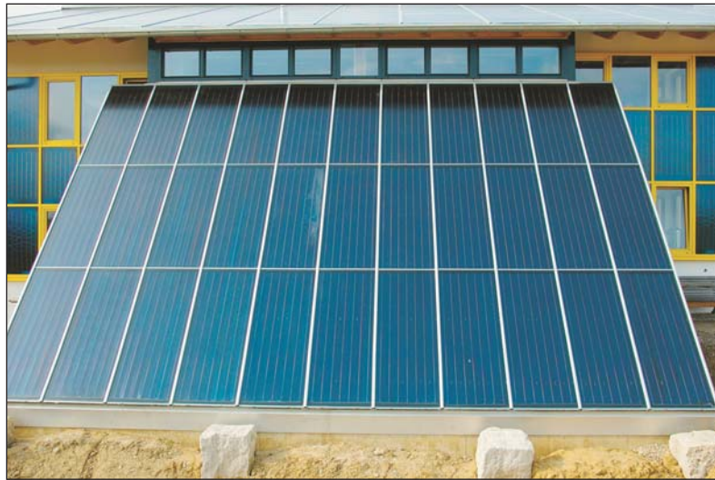
Der größte Teil der Kollektoranlage ist ein Vorbau mit 50 Grad Dachneigung und 56 Quadratmeter Kollektorfläche.
