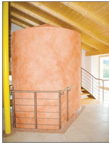
Der Pufferspeicher mit seinen über 25 Kubikmetern reicht vom Keller bis ins Obergeschoss.
