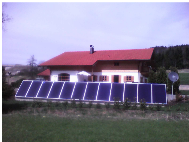
Damit die Ansicht des Hauses erhalten bleibt, wurde die Kollektoranlage am Südhang frei aufgeständert.
