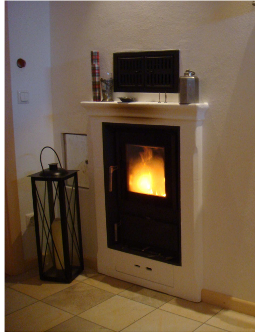
Der POWALI OFKA Holz-Zentralheizungs-ofen wird vom Gang aus beschickt.
