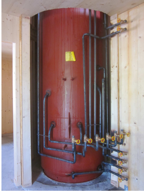
Der verrohrte aber noch unverkleidete SWISS-SOLAR Pufferspeicher mit 6.300 l Inhalt steht zentral im Gebäude und reicht über zwei Stockwerke.
