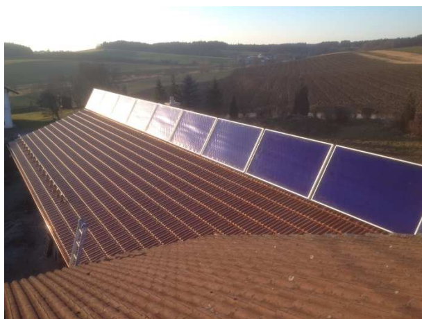
Die Kollektorneigung von 60 Grad sind optimiert für hohe Leistung im Winter und in der Übergangszeit.
