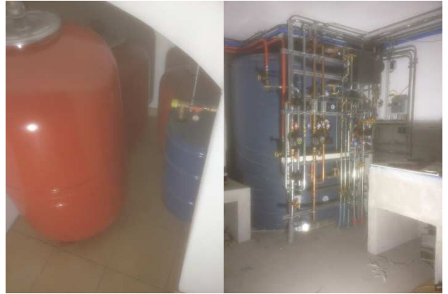
Der Technikraum (noch nicht ganz fertig). Die ganze Haustechnik ist vor dem Pufferspeicher angeordnet. Die Ausdehnungsgefäße für Heizung und Solaranlage mit Auffanggefäß sind unter der Treppe versteckt.
