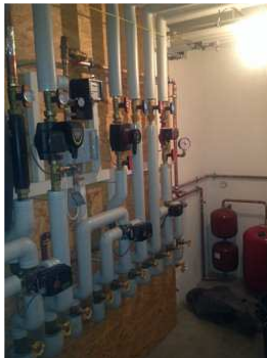
Ein Blick in den Technikraum. Der Speicher ist hinter der Trockenbauwand eingehaust.
