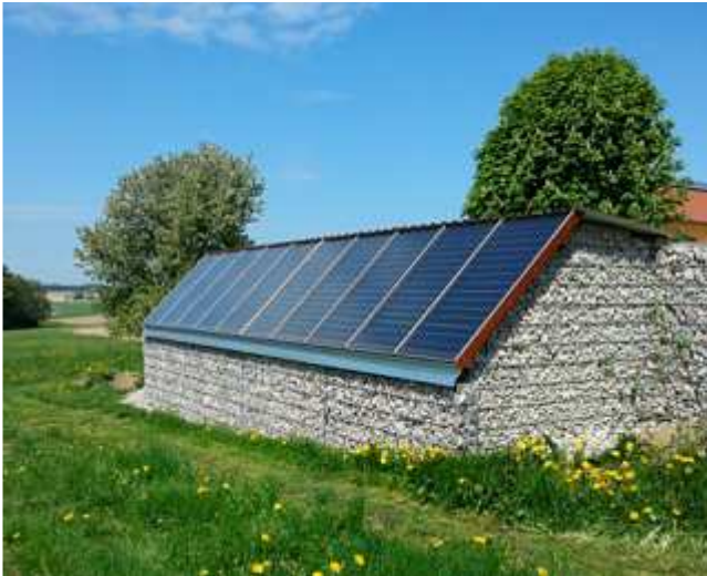
Die Kollektoranlage wurde auf aufgeschütteten Steingabionen montiert – optisch und technisch eine sehr gelungene Lösung.
