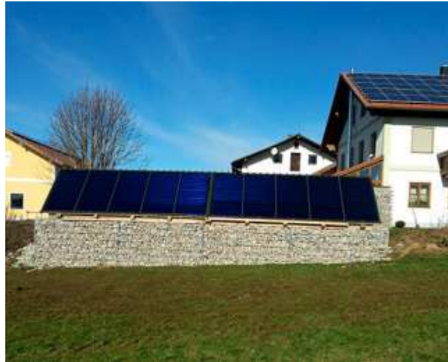
Ein Bild gleich nach der Kollektormontage – die Unterkonstruktion ist noch zu erkennen. Das Hausdach ist komplett mit PV-Modulen belegt, für den Kollektor war kein Platz.
