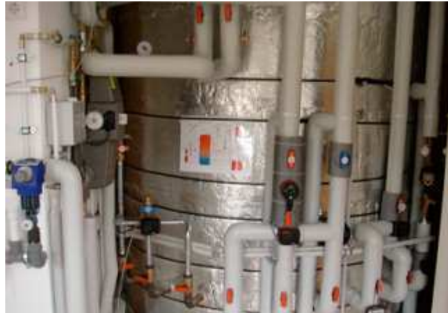
Der knapp 10 m 3 fassende Pufferspeicher reicht über zwei Etagen. Die Technik ist im Hauswirtschaftsraum im EG angeordnet.
