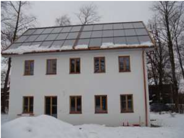
Winterimpressionen – die komplette Süddachhälfte ist mit Kollektoren belegt.
