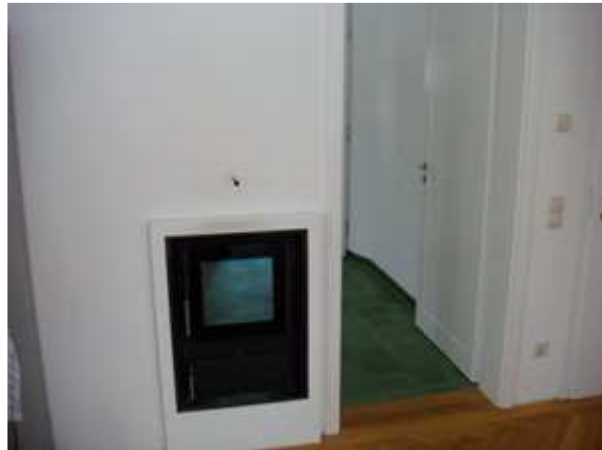
Nachheizung: Der POWALL Zentralheizungsöfen ist in der Wand zwischen Küche und Gang integriert
