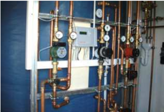
Der SWISS-SOLAR Pufferspeicher mit Verrohrung und Armaturen.
