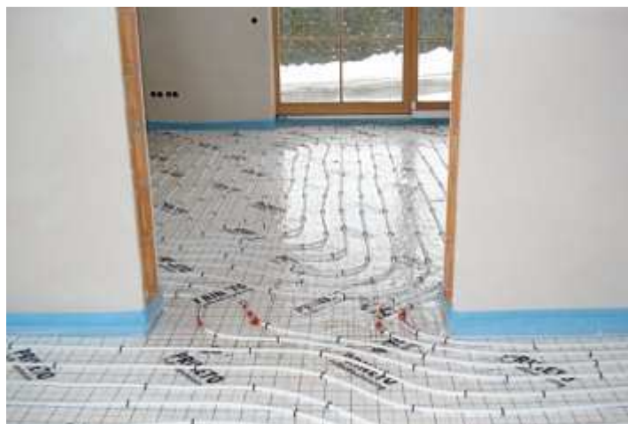
Die Heizflächen sind konsequent auf niedrigste
