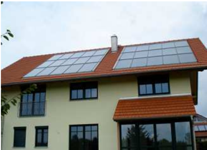
Schön integriert: Die 60 m 2 große Kollektorfläche Typ SOLAR HFK wurde auf zwei gleiche Felder aufgeteilt.
