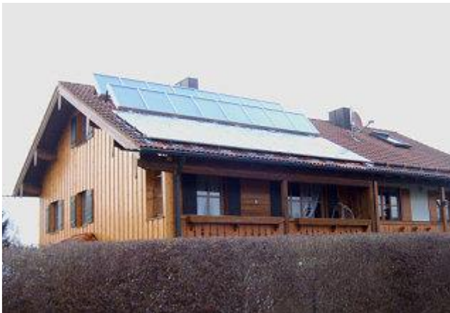
Der WINKLER-Solar Variosol A Hochleistungskollektor mit Antireflexglas wurde in zwei Reihen mit einem optimalen Anstellwinkel von ca. 60° montiert. Darunter wurde zusätzlich eine Soalstromanlage platziert.
