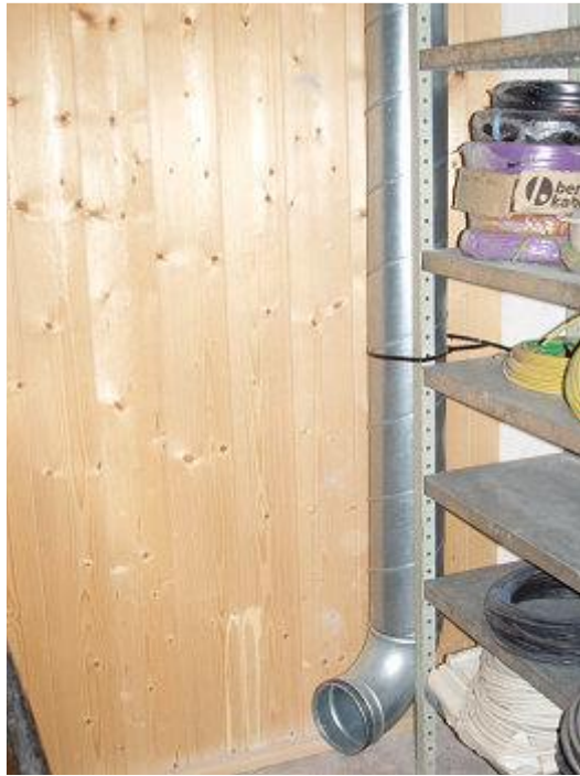
Die Luftabsaugung erfolgt in Bodennähe.
