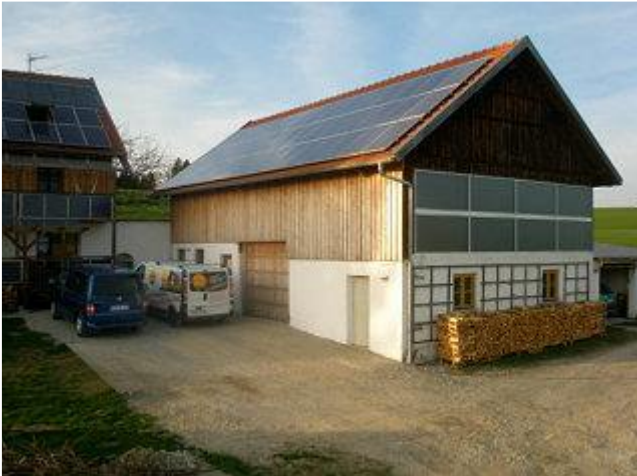
Die Luftkollektoranlage ist auf der Süd-Ost-Fassade senkrecht montiert.
